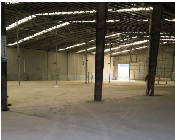
项目生产车间
